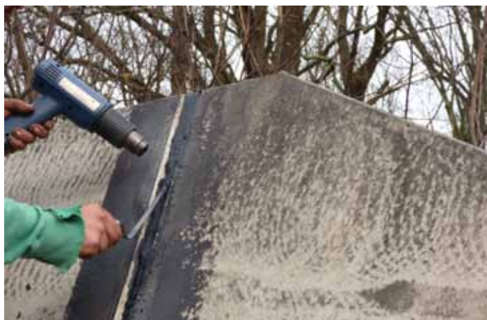
7 Nacharbeiten bei mechanischen Beschädigungen.
