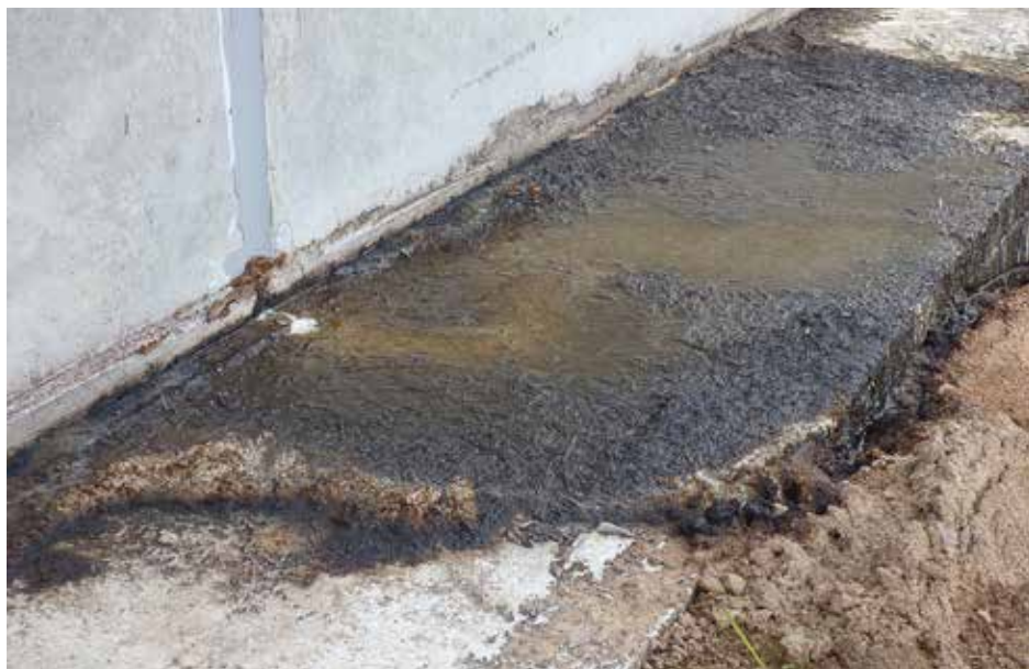
Abbildung 3: Schadensbild an der Rückseite
