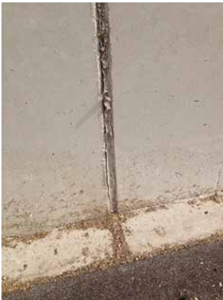
Abbildung 4: Zerstörte Fuge mit Kaltverguss
