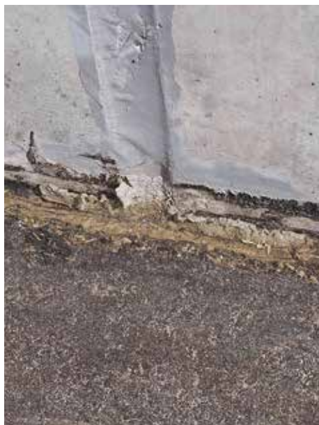
Abbildung 2: Schadensbild am inneren Boden-Wandanschluss
